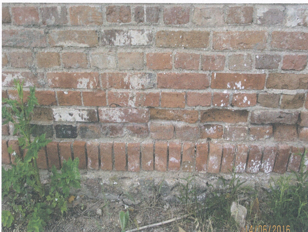
Foto Nr. 5. Cokola bojājumi un aizsargapmales neesamība pa asi „4”.
