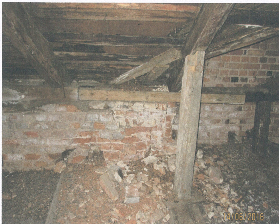
Foto Nr. 13. Jumta konstrukcijas pūšanas pēdas. Ķieģeļa mūra sabrukuma pēdas.
